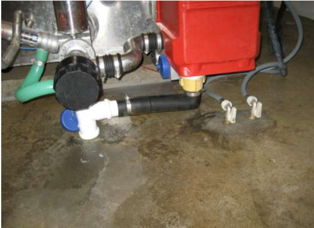
Sé vandað til verka má tengja mjaltþjóna, bæði inntaksvatn og frárennsli, beint við stúta í gólfum. Hér var skilið eftir smá svigrúm til tilfærslu stúta og lagt í að lokinni tengingu. Snyrtilegt og fínt.
