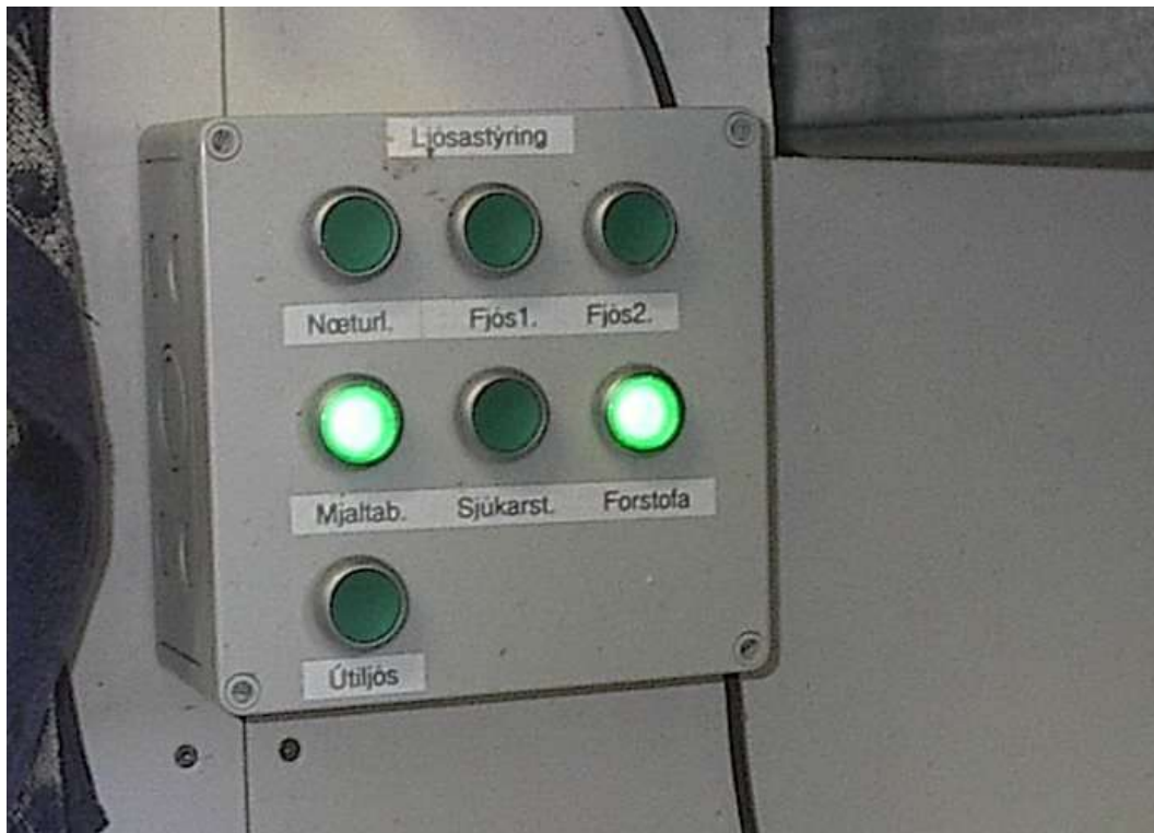
Mjög skipulega uppsett ljósastýringakerfi.
