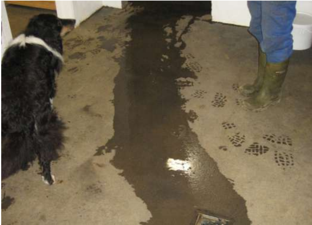
Em eitt dæmið um slaka gólfvinnu, vatnstaumur liggur langa leið að niðurfalli.
