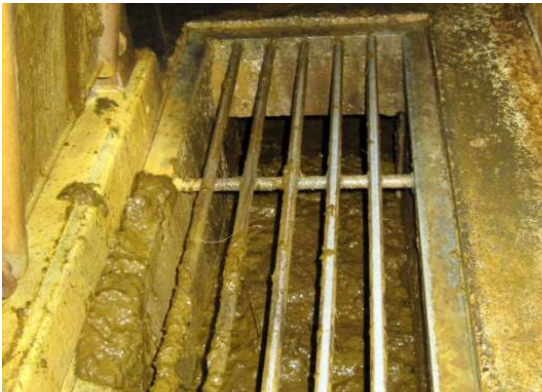
Við mjaltabjóna þarf að leiða mykju frá sk. mykjurennu. Hér er lítill fleytiflór aftan við mjaltabjón.
