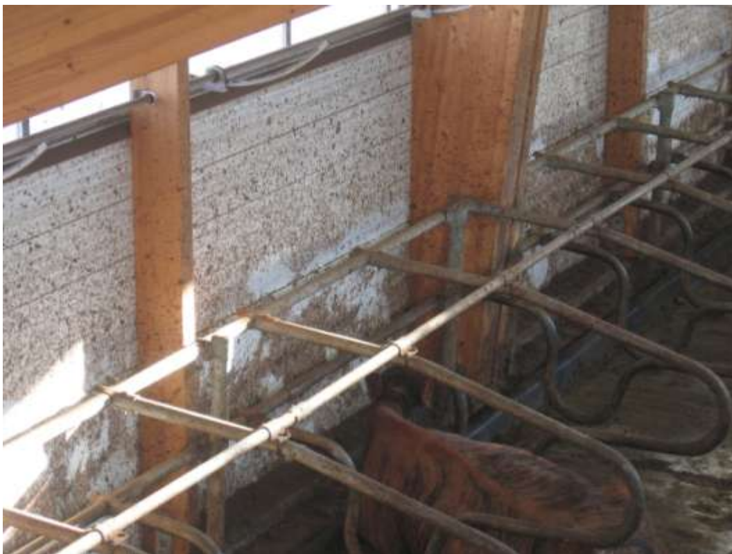
Fram kom við úttektina að víða hafa nautgripir náð að sleikja innréttingar þannig að skaði varð af enda sýrur í munnvatni sem geta valdið tæringu.
