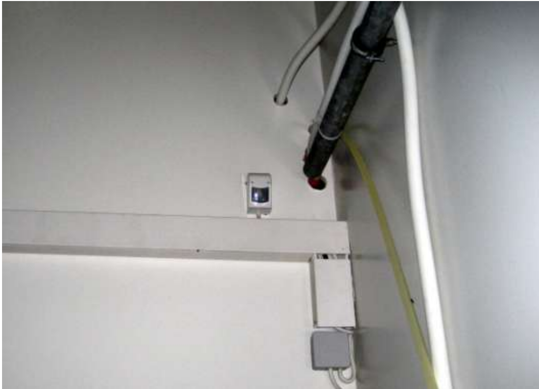
Hreyfiskynjari í mjólkurhúsi sér um að kveikja ljósið þegar inn í það er gengið.
