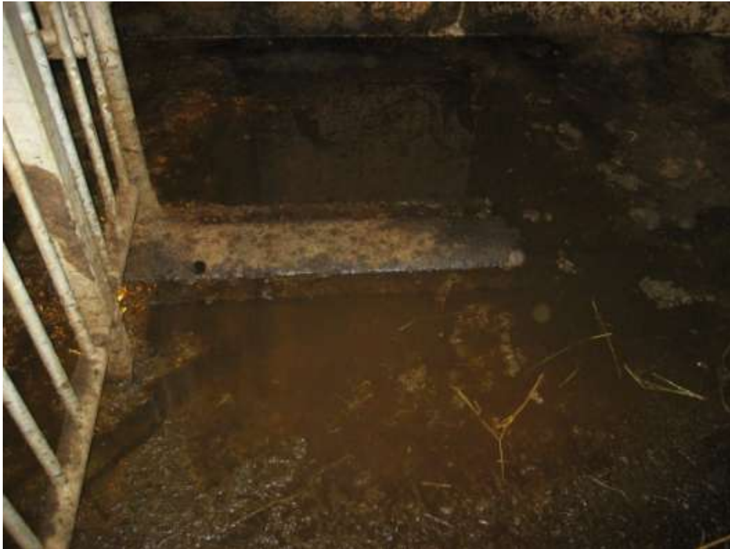
Hér er greinileg fyrirstaða fyrir vatn og hland að komast í burtu
