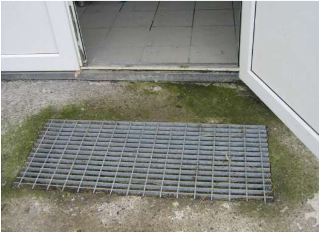
Ótrúlega víða vantar niðurföll í stéttar jafnt utan- sem innandyra. Hér er þó afar einföld og góð lausn með rúmtaksmikilli rist við inngang í mjólkurhús.
