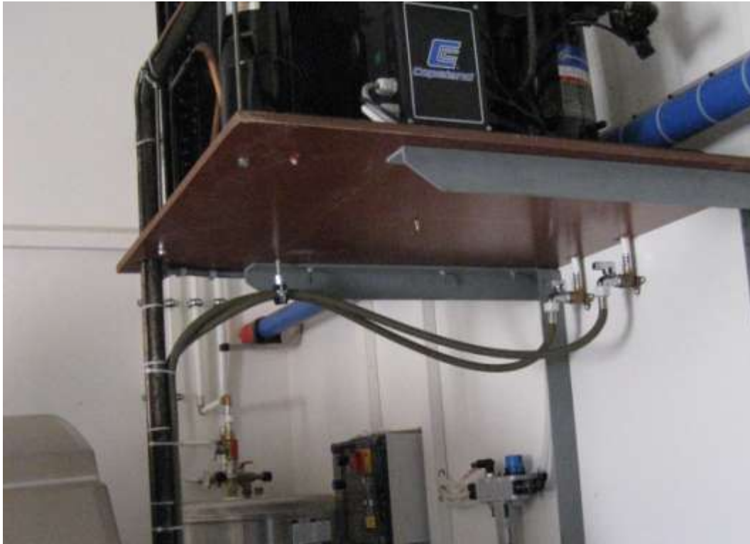
Þar sem því er við komið er um að gera að koma kælipressu mjólkurkælis upp á vegg svo auðveldlega sé gegnt undir, það nýtir pláss mjólkurhússins afar vel.
