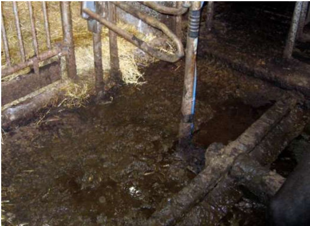
Hér gleymdist við hönnun að gera ráð fyrir flokkunarhlíði og var því ekki hægt að skafa svæðið út að burðarstíunni sem sést þarna í til vinstri. Hér hefði auðveldlega mátt leysa málið með rimlum á þessu svæði.
