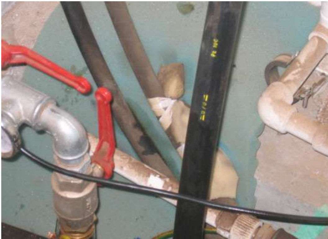
Á þessu búi lágu glussaslöngur um krappa brún hins steypa sökkuls sem gerði það að verkum að gat kom á slöngurnar. Hér er búið að koma fyrir svampi til þess að mýkja lagnaleiðina.
