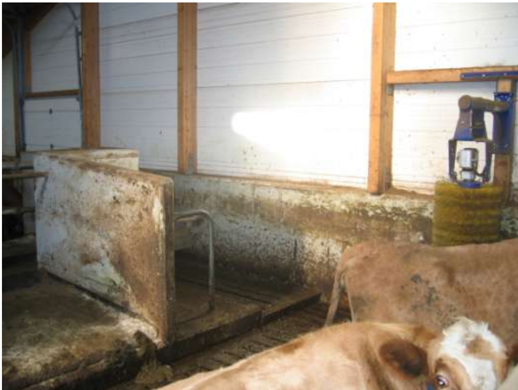
Ein leið til þess að verja veggeiningarnar er að steypa sökkulinn hátt upp eins og hér var gert.
