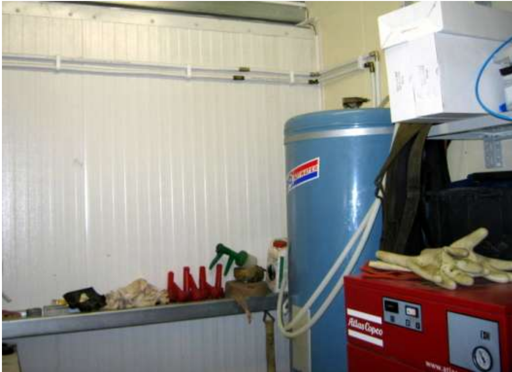
Mjög algeng aðkoma að tækjakompu, þar sem inni var mjög heitt enda engin loftræsting til staðar.
