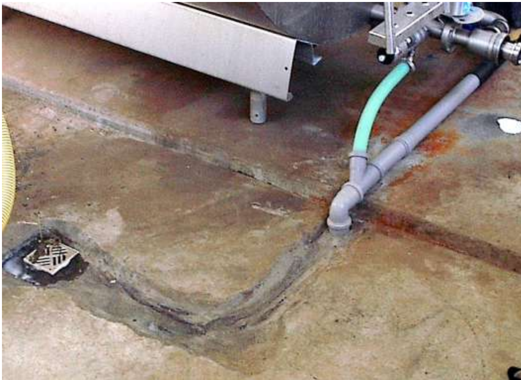
Niðurfall bæði lítið og ekki á góðum stað fyrir affall mjólkurtanks.
